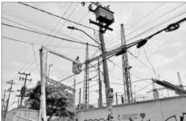
▲ La instalación de sistemas de almacenamiento de energía es una opción para negocios y hogares ante la posibilidad de que persistan las fallas en el suministro, según el director de la empresa Enersave. En la gráfica, trabajadores de CFE revisan líneas en una subestación de la Ciudad de México. Foto La Jornada
