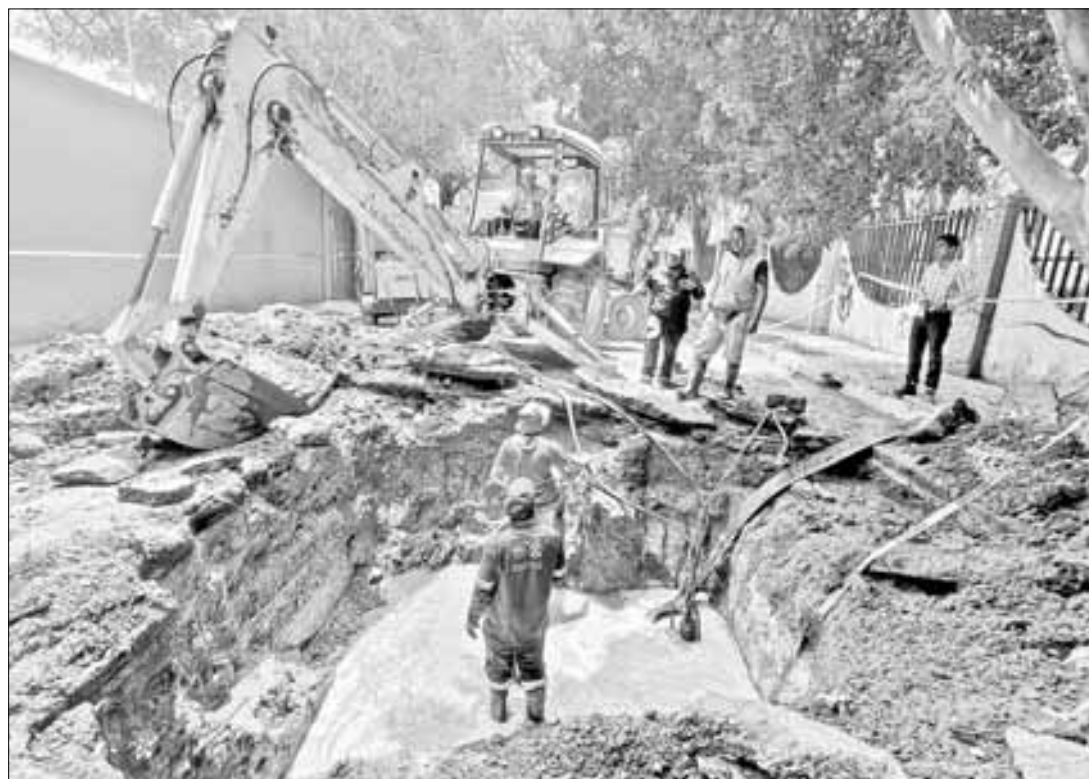
▲ Personal del Sistema de Aguas de la Ciudad de México acudió a reparar una enorme fuga de agua en la calle Balvanera, de la colonia Juan Escutia,
