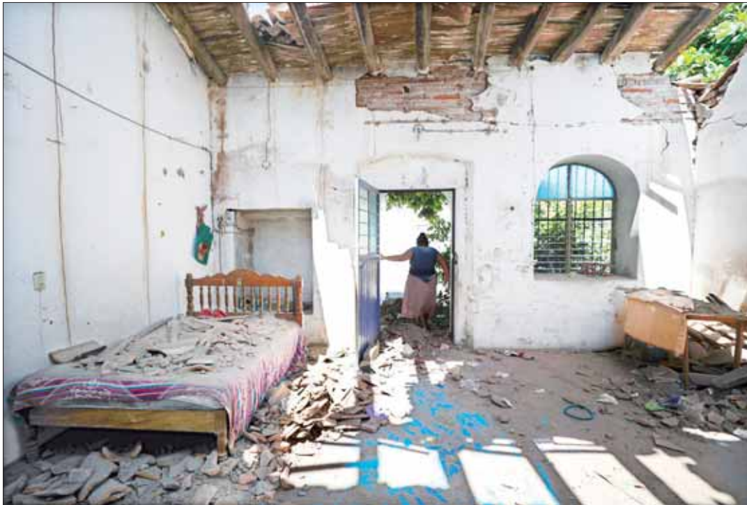
Los daños en cientos de viviendas en Juchitán, Oaxaca, son catastróficos tras el sismo de 8.2 grados Richter ■ Foto Alfredo Domínguez
